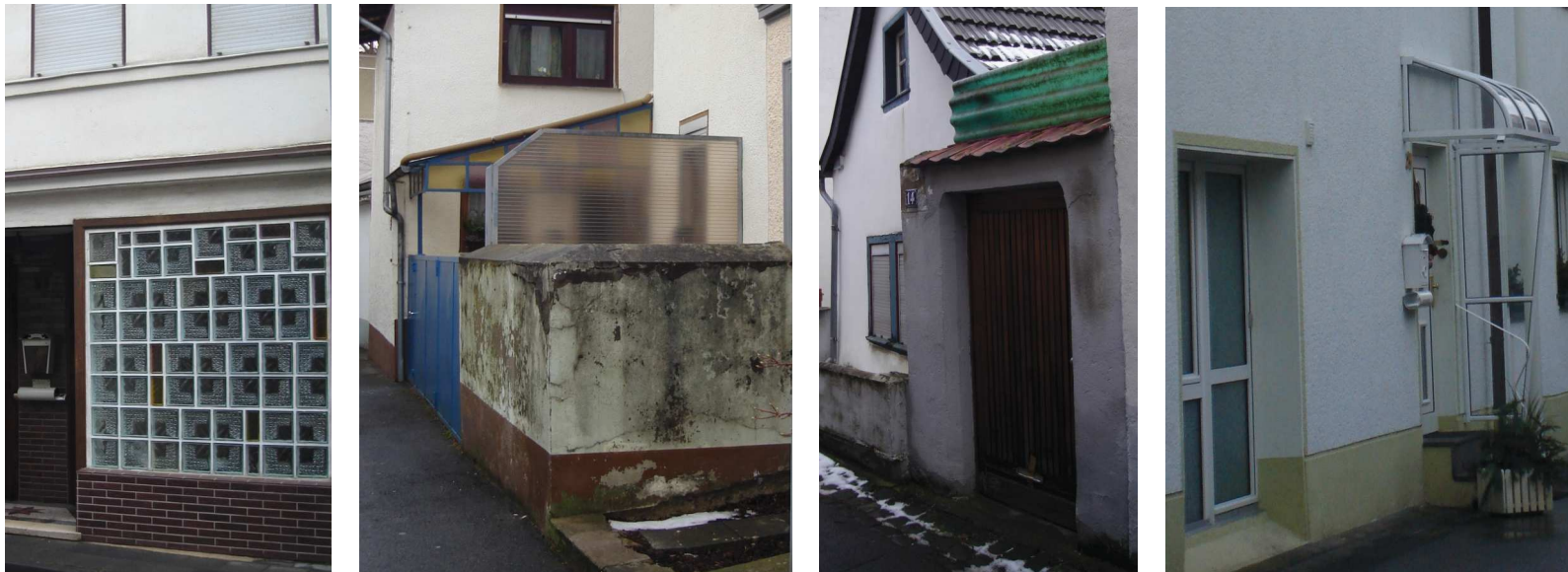
Modernisierungs- und Instandsetzungsbedarf
