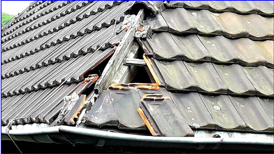
Abb. 82: Defekte Dachdeckung des Nebengebäudes N1
