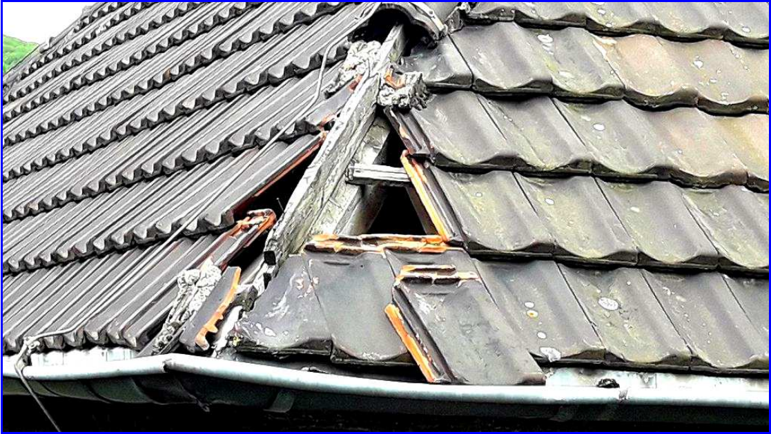
Abb. 82: Defekte Dachdeckung des Nebengebäudes N1
